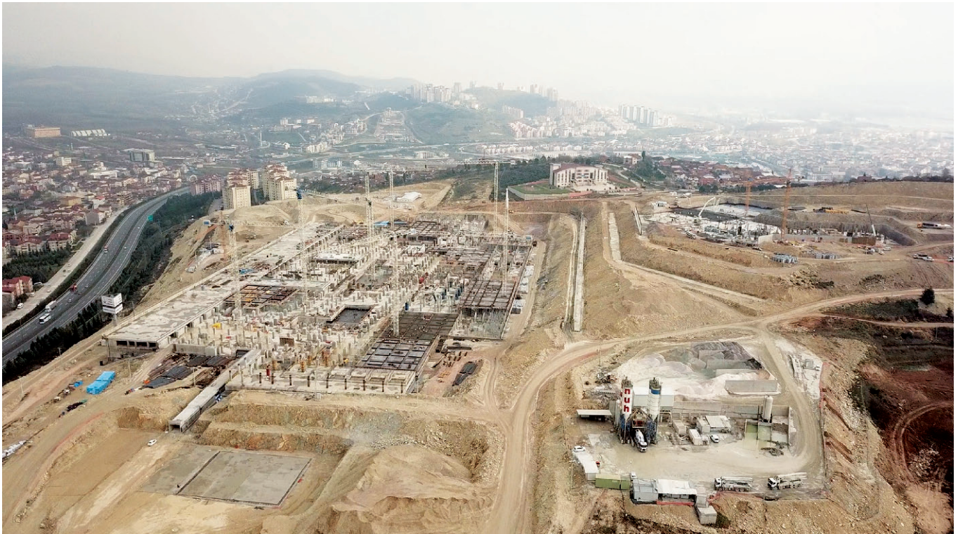
Das neue Krankenhaus in Kocaeli ist gegen Erdbeben gesichert.
