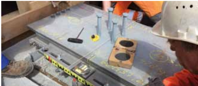
Instalación en Botlekbrug, Países Bajos
