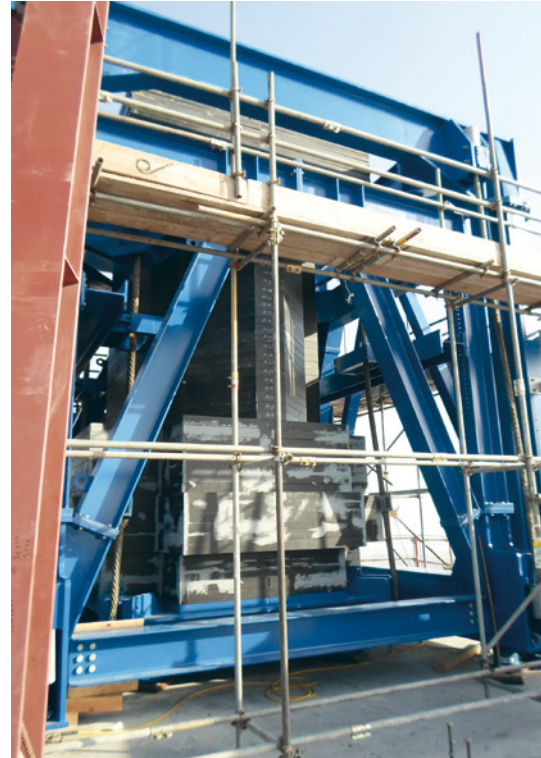
Das weitgehend eingebaute Dämpfersystem in Blau. Grau erscheint die Masse mit ausgebesselter Korrosionsbeschichtung. Rostrot ist der Träger für die Fassade.
