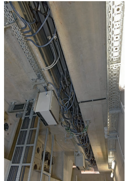
16 Schaltschränke im Wartungsgang von Achse 50 © Hajo Dietz
