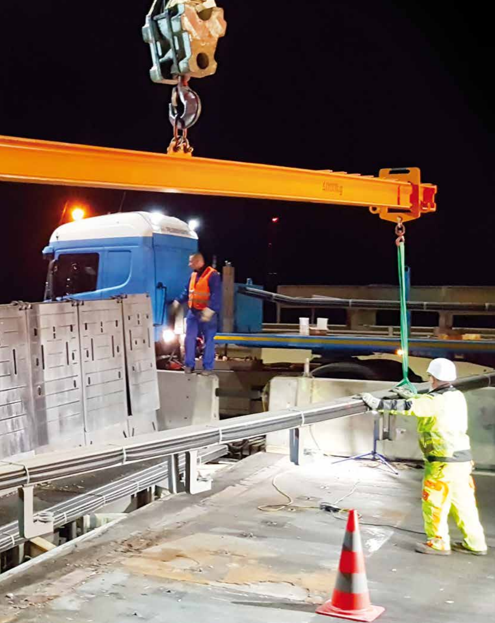
Einhub des 2. Mittelträgerpaares vor der Wand der geöffneten MMBS-Elemente. Keine 10 Minuten später rollte hier auf einer Spur der Verkehr wieder.
